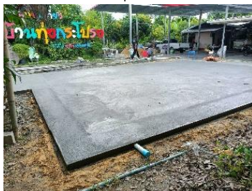
3. พื้นคอนกรีตที่เป็นฐานของระบบบอบแห้งพลังงาน
