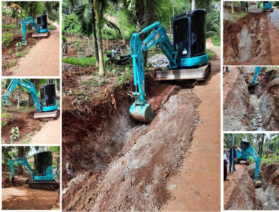
ภาพที่ 4.7 การขุดหลุมธนาคารน้ำใต้ดินระบบปิดระดับองค์กรโดยใช้รถแบคโฮ (ภาพถ่าย: 24 มิ.ย. 2564)
