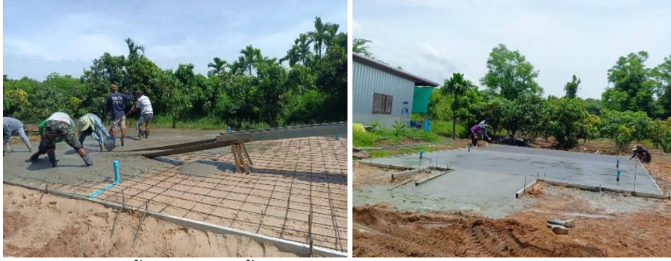
ขั้นตอนการเทพื้นคอนกรีต โรยปูนซีเมนต์ผสมผงปูนดำ
