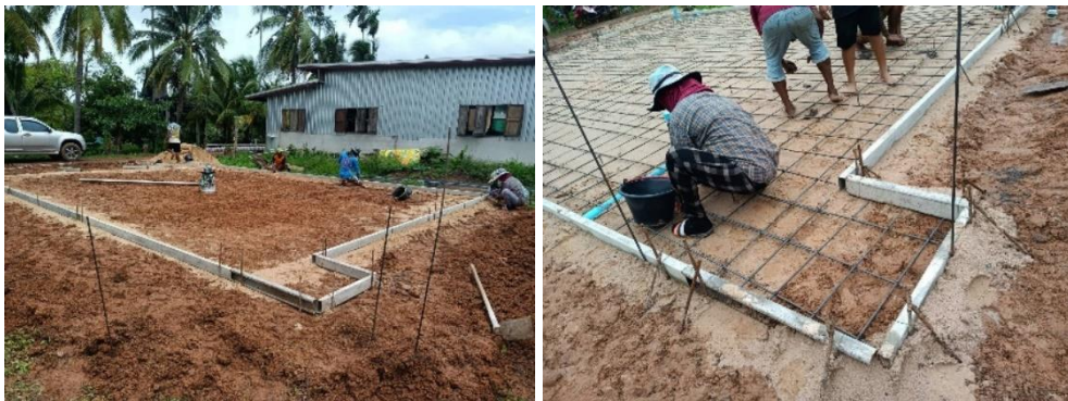
ขั้นตอนการตีแบบ ผูกเหล็กและวางระบบท่อระบายน้ำ
