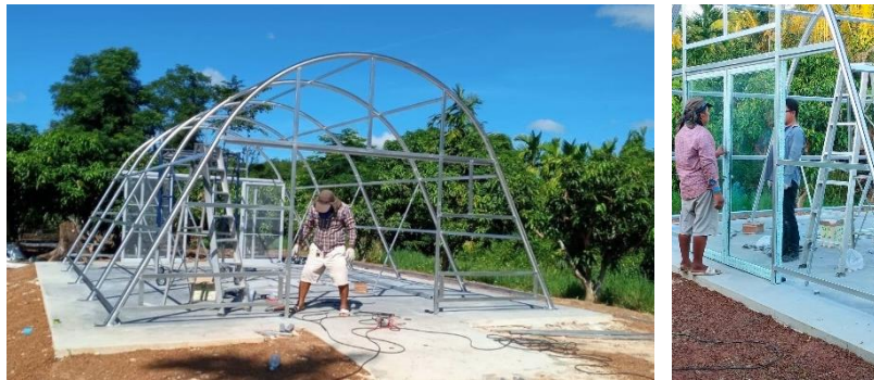
ขั้นตอนการตัดและเชื่อมเหล็กบริเวณด้านหน้าและด้านหลังของโครงสร้างสำหรับติดตั้งประตู
