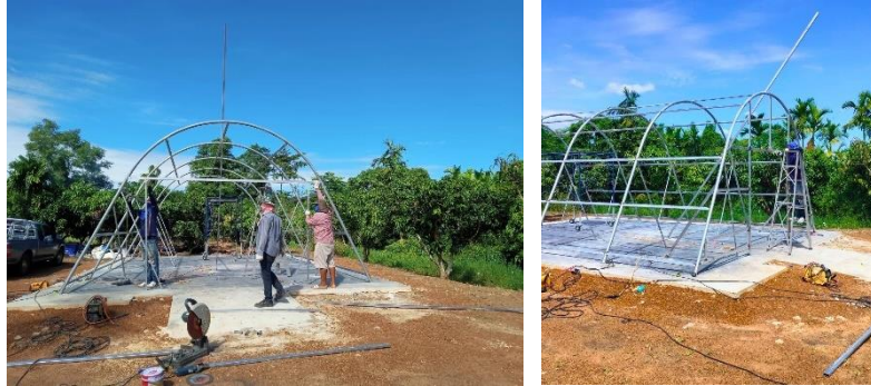
ขั้นตอนจับระดับเสาเหล็กกับโครงโค้งพาราโบลาและเชื่อมโครงแต่ละโครงเข้ากันด้วยเหล็กแป
