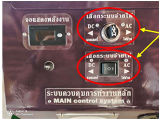
ภาพที่ 29 การเปิดปุ่มสวิตซ์หลักควบคุมระบบจ่ายไฟในเครื่อง
