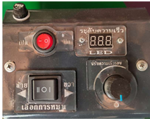
ภาพที่ 41 เปิดสวิตช์ แล้วกดปุ่มเลือกทิศทางการหมุน
