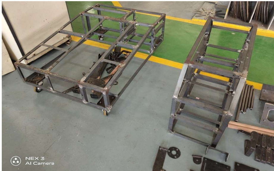
ภาพที่ 64 ดำเนินการตัดเชื่อมประกอบโครงสร้างเครื่องผลิตเส้นไหมทอมือพลังงานแสงอาทิตย์แบบครบวงจร
