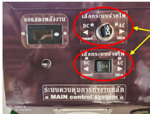
ภาพที่ 46 เปิดสวิทซ์หลักควบคุมการจ่ายไฟ
